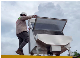
CRIBAS Y REJAS PARA AGUAS RESIDUALES
