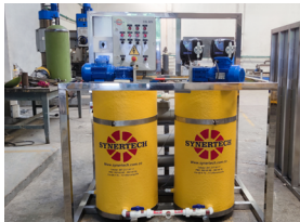
ESTACIÓN DE DOSIFICACIÓN QUÍMICA
